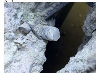
(d) Ermüdungsbruch der Stahlbewehrung.
