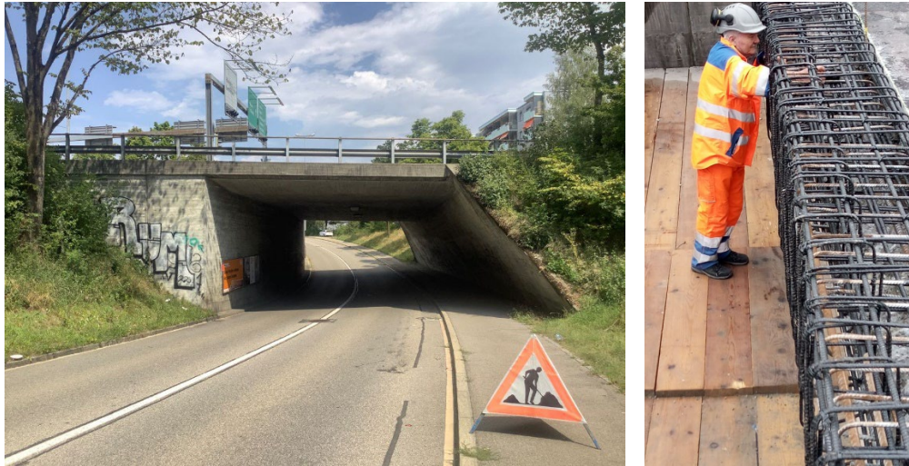
Abb. 3.10 Links: Bauwerk vor der Instandsetzung. Rechts: Montage Bewehrung. Bild Basalt Fibertec GmbH
